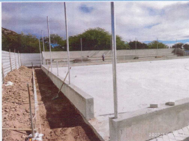
Foto 02 - Vista parcial destacando mureta, alambrado em execução e piso da quadra concretado.
