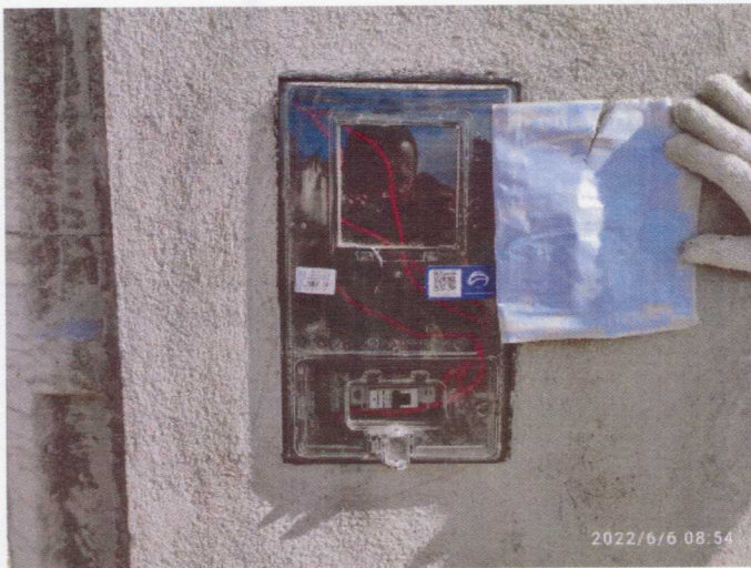
Foto 04 - Vista parcial destacando o quadro de luz instalado.
