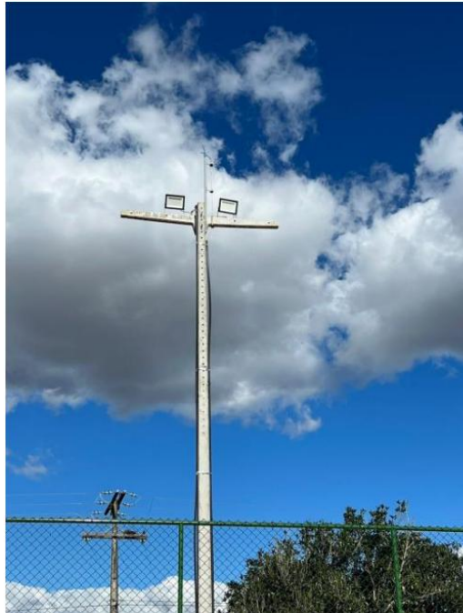
Foto 03 – Sistema de iluminação.
