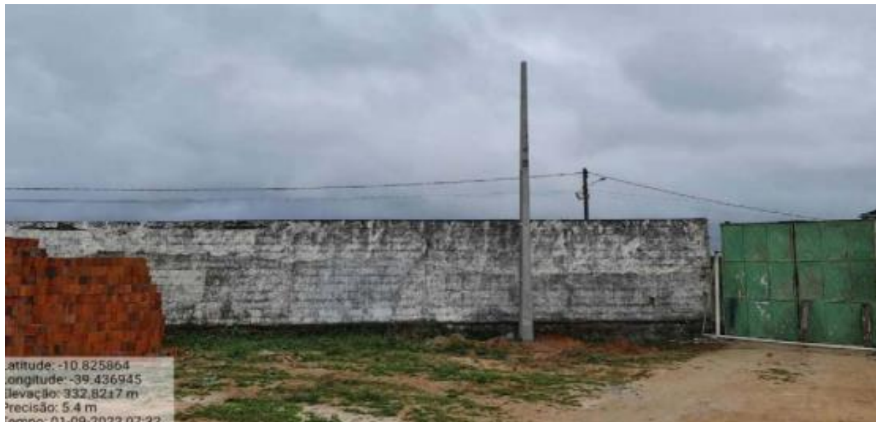
Foto 05 – Poste padrão de entrada.
