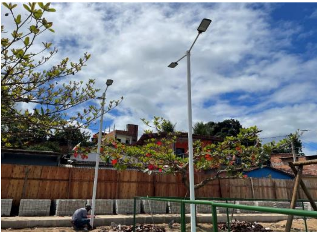
Foto 06 – Instalação de iluminação pública.
