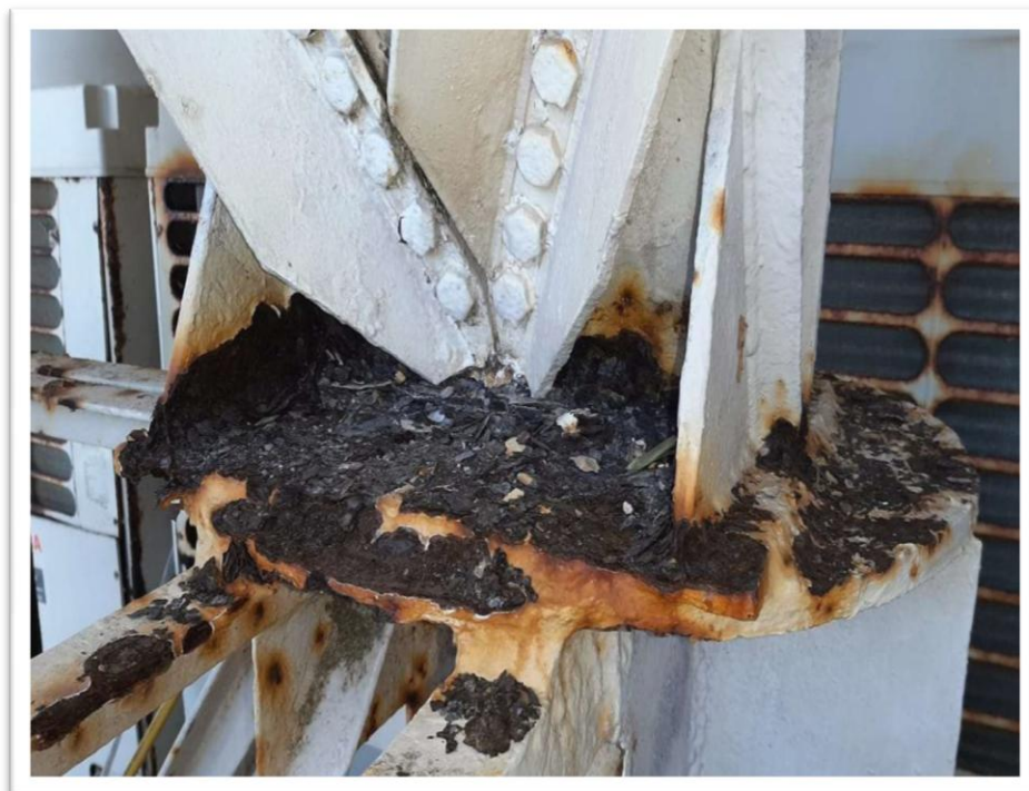
FOTO 11 – Estrutura do pilar danificada pela corrosão
