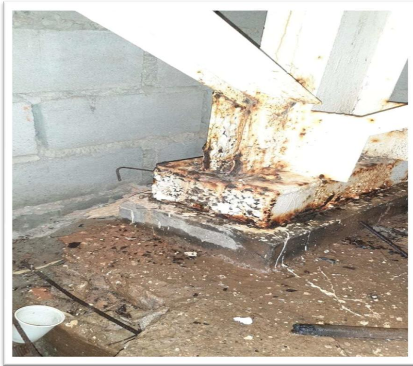
FOTO 01 - Base dos pilares com corrosão
