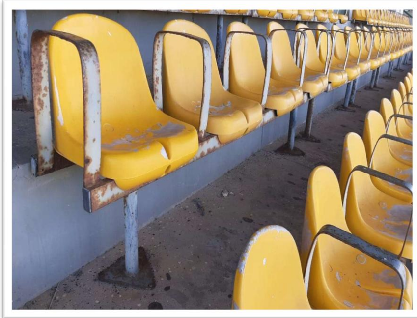
FOTO 13 - Base e estrutura das cadeiras da Tribuna de honra, necessitam de reparos devido a corrosão.
