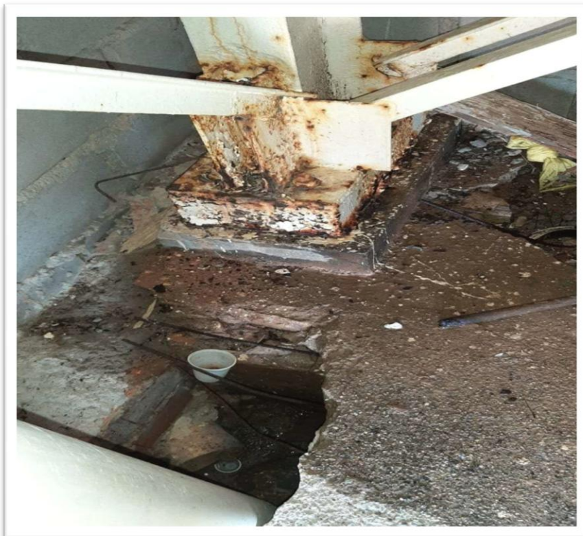
FOTO 10 - Base com corrosão devido a falha na execução dos drenos do Sistema de climatização
