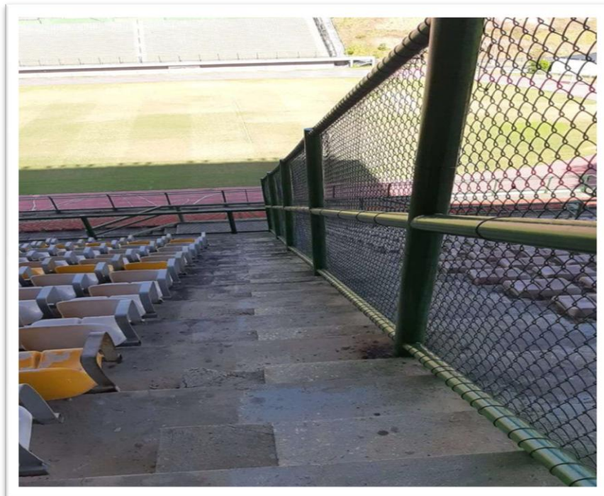
FOTO 14 - Toda a base dos alambrados necessita tratamento contra a corrosão
