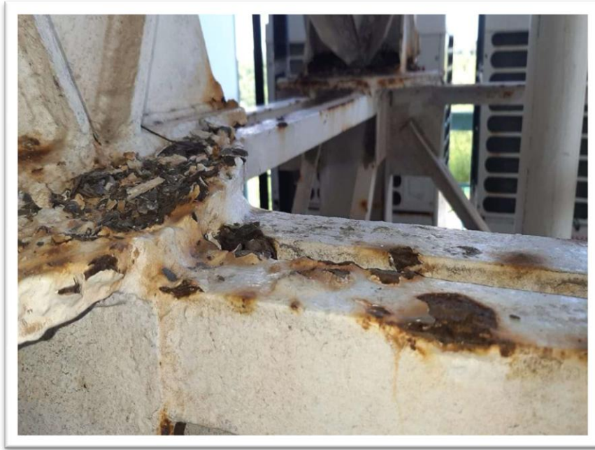
FOTO 09 - Estrutura do pilar com perda de seção
