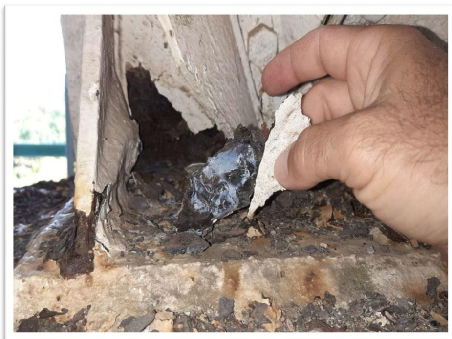
FOTO12 – Estrutura danificada pela corrosão
