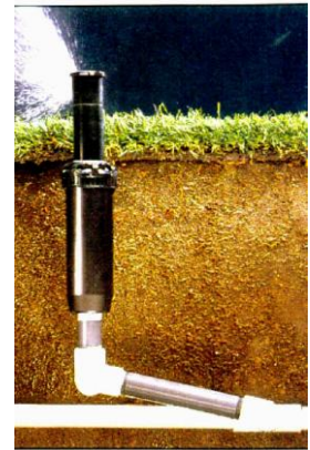
Detalhe swing e aspersor no solo
