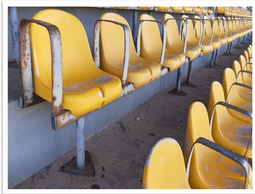
FOTO 13 - Base e estrutura das cadeiras da Tribuna de honra, necessitam de reparos devido a corrosão.
