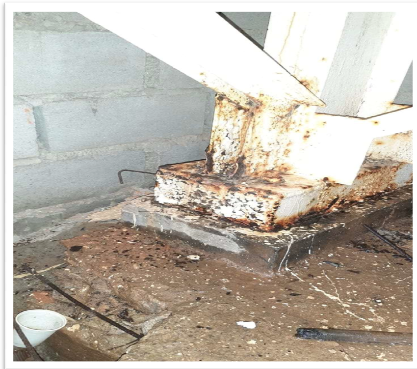
FOTO 01 - Base dos pilares com corrosão
