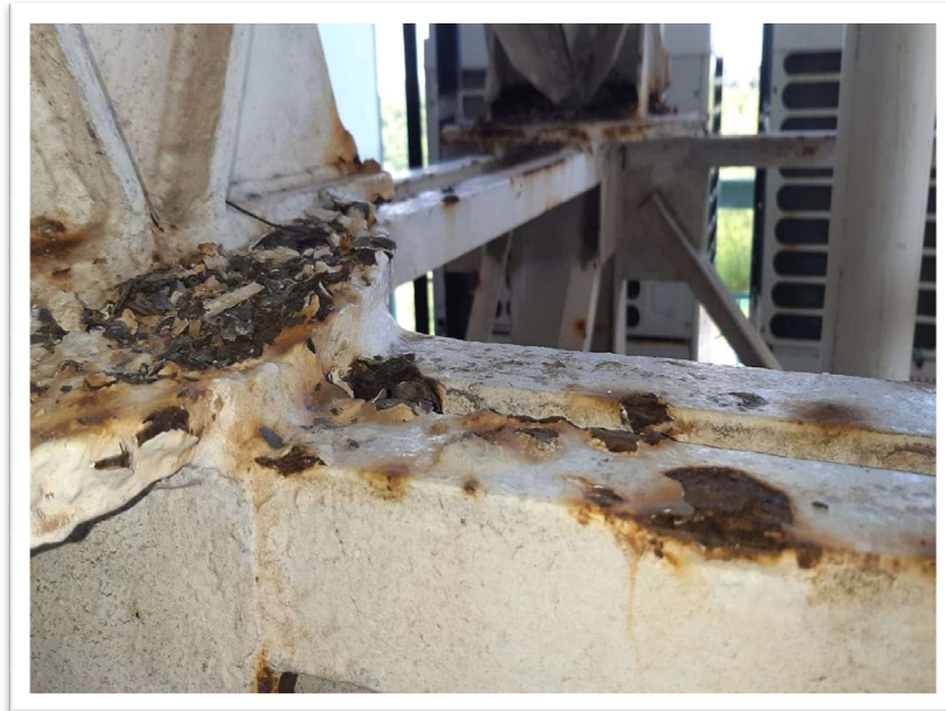
FOTO 09 - Estrutura do pilar com perda de seção
