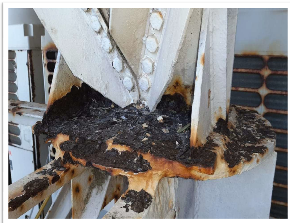
FOTO 11 – Estrutura do pilar danificada pela corrosão
