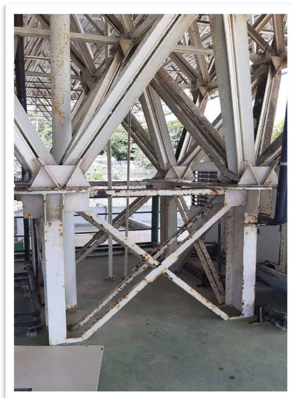
FOTO 05 - Estrutura do pilar da cobertura espacial com corrosão
