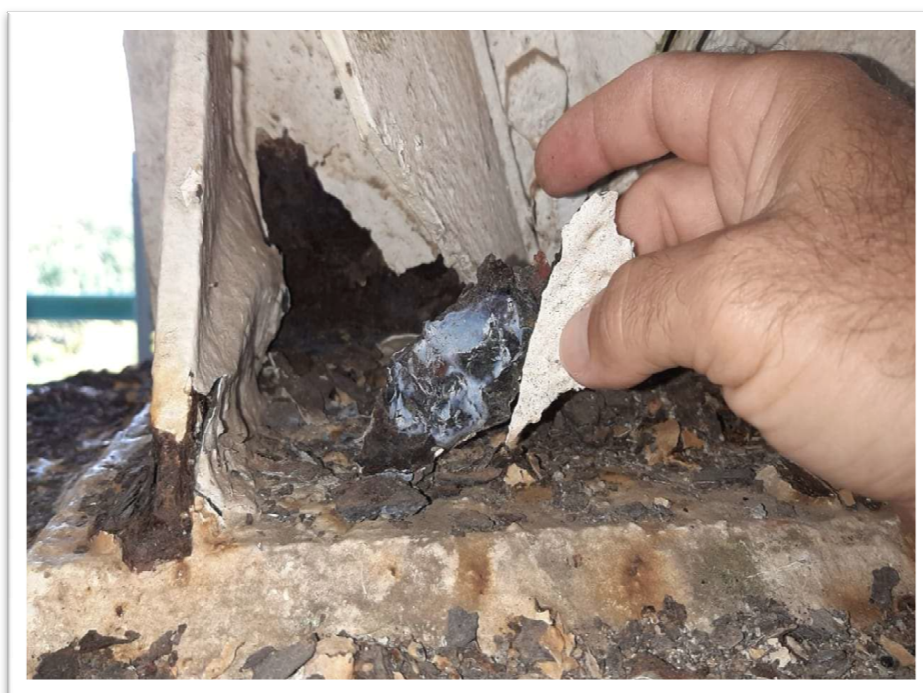
FOTO12 – Estrutura danificada pela corrosão
