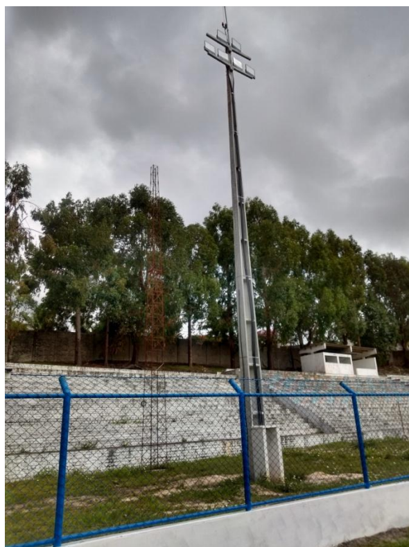
Foto 02 – Refletores Led Instalados
