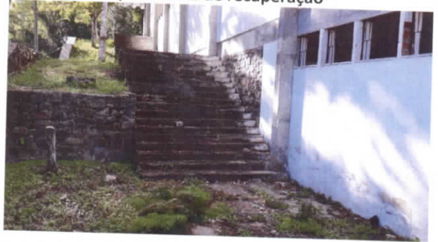
Foto 02 – Vista parcial destacando esquadrias pendentes de recuperação
