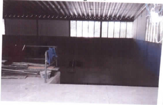
Foto 01 – Vista parcial destacando de parede e piso do ginásio
