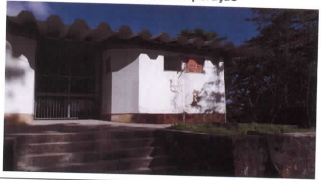
Foto 04 - Vista parcial destacando esquadrias pendentes de recuperação
