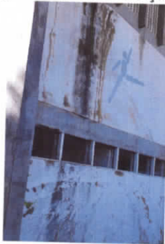
Foto 03 – Vista parcial destacando pintura de alvenaria pendente de execução
