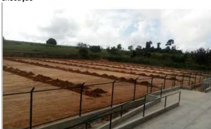
Foto 05 – Vista parcial destacando a arquibancada, o alambrado e os trabalhos do gramado em execução
