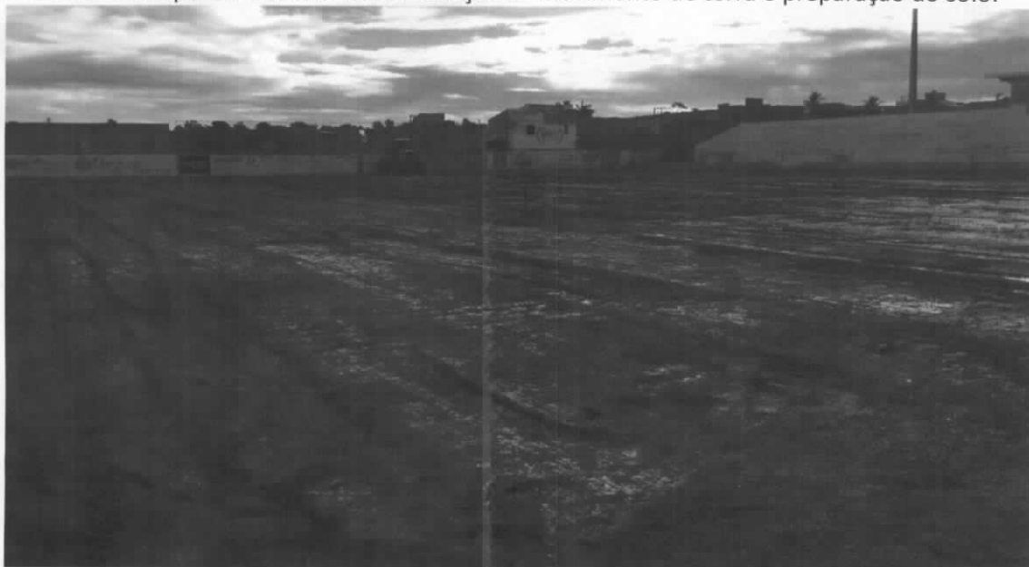
Foto 02 – Vista parcial destacando os serviços de movimento de terra e preparação do solo.
