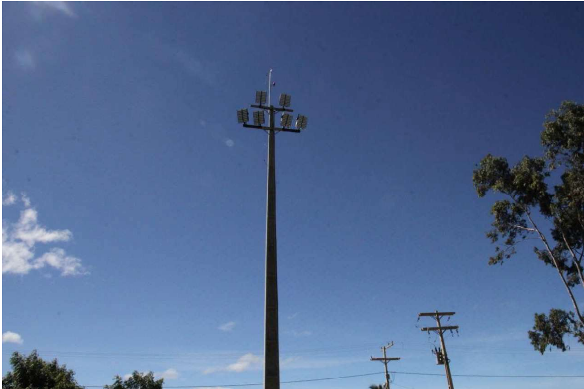
Foto 03 - Vista do poste com refletores em LED
