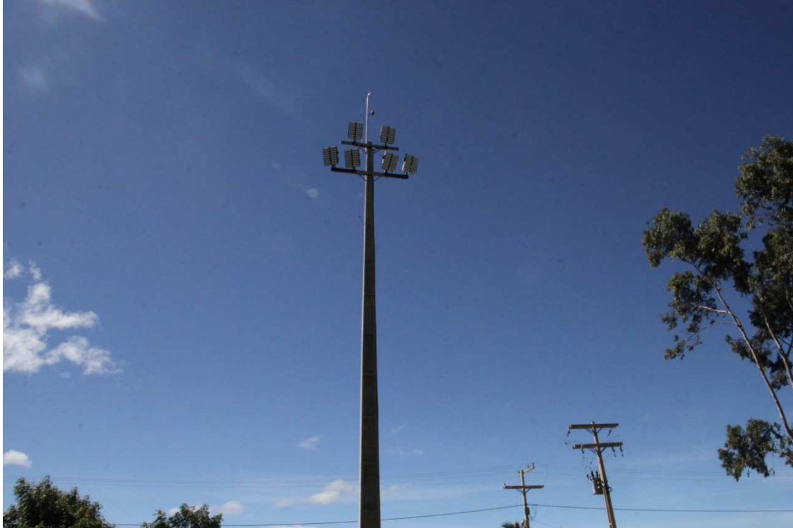
Foto 03 - Vista do poste com refletores em LED
