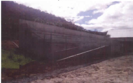
Foto 03 – Vista parcial destacando arquibancada sem pintura
