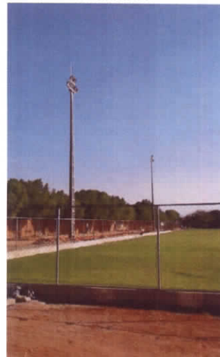
Foto 02 – Vista parcial destacando refletores instalados
