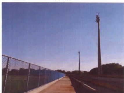
Foto 05 – Visão Poste, Gradil, Mureta, Refletores e SPDA
