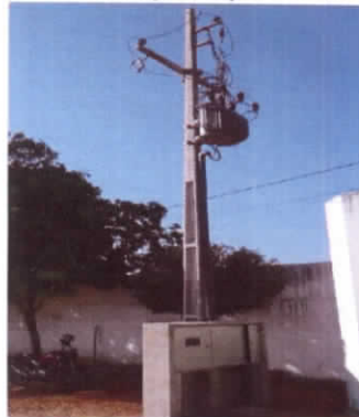
Foto 02 – Subestação e quadro de energia
