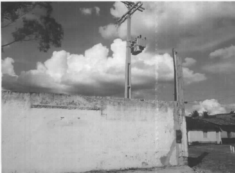
Foto 04– Vista do transformador instalado.
