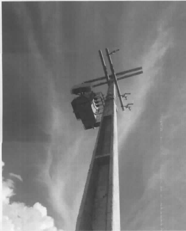
Foto 01 – Vista do transformador instalado.
