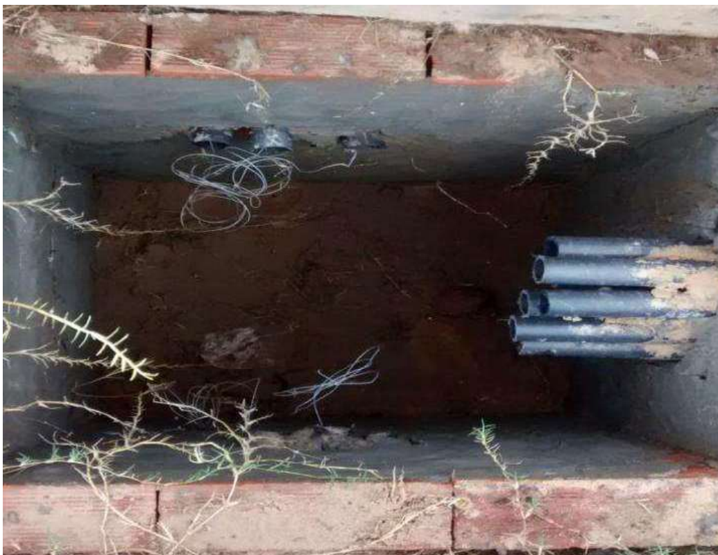
Foto 02 – Caixas não concluídas e cabos não instalados.
