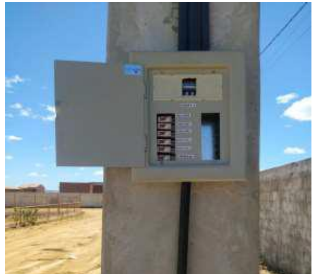
Foto 02 – Vista do quadro de energia
