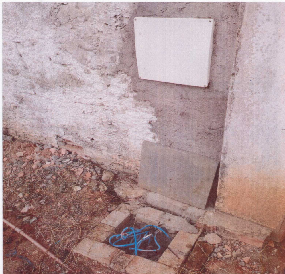
FOTO 04 – Fundo do Padrão de entrada de energia
