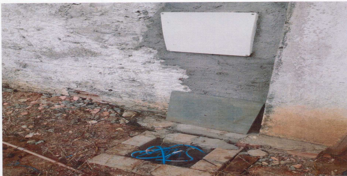
FOTO 04 – CAIXA DE PSSAGEM DE CABOS ELETRICOS
