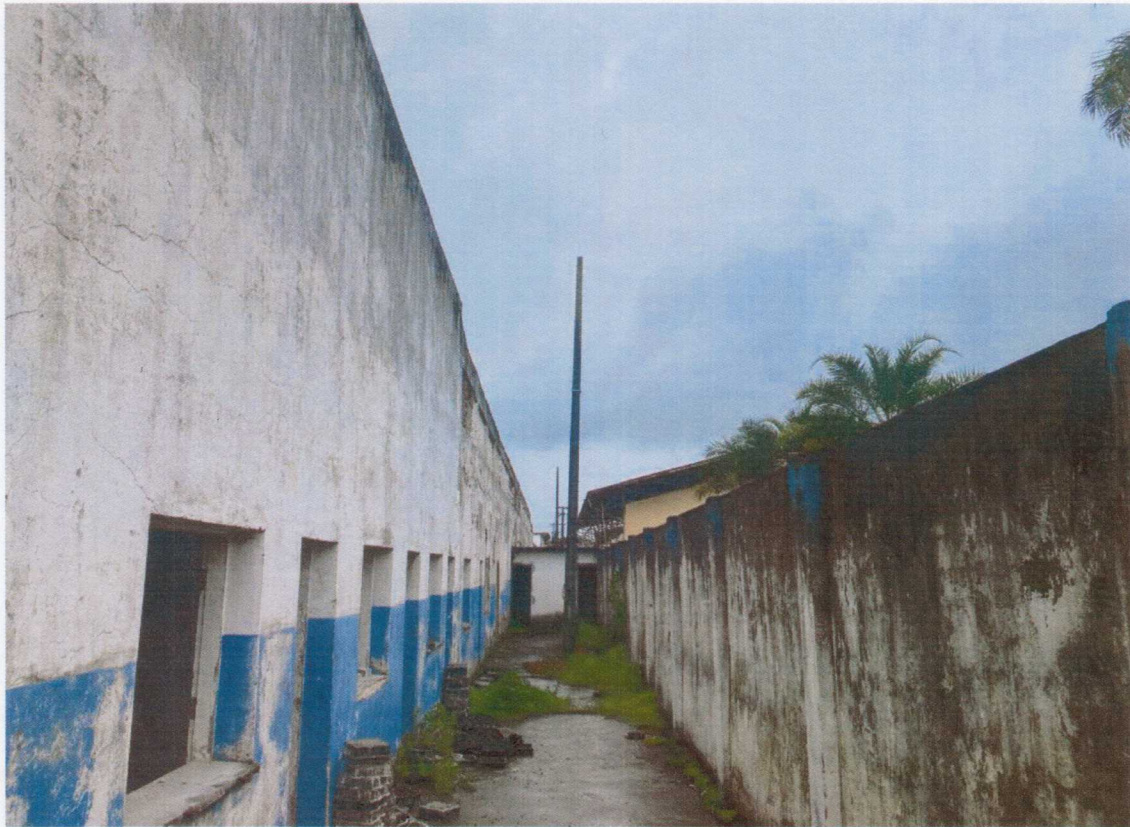
FOTO 01 – Poste antigo 01, ainda não trocado.
