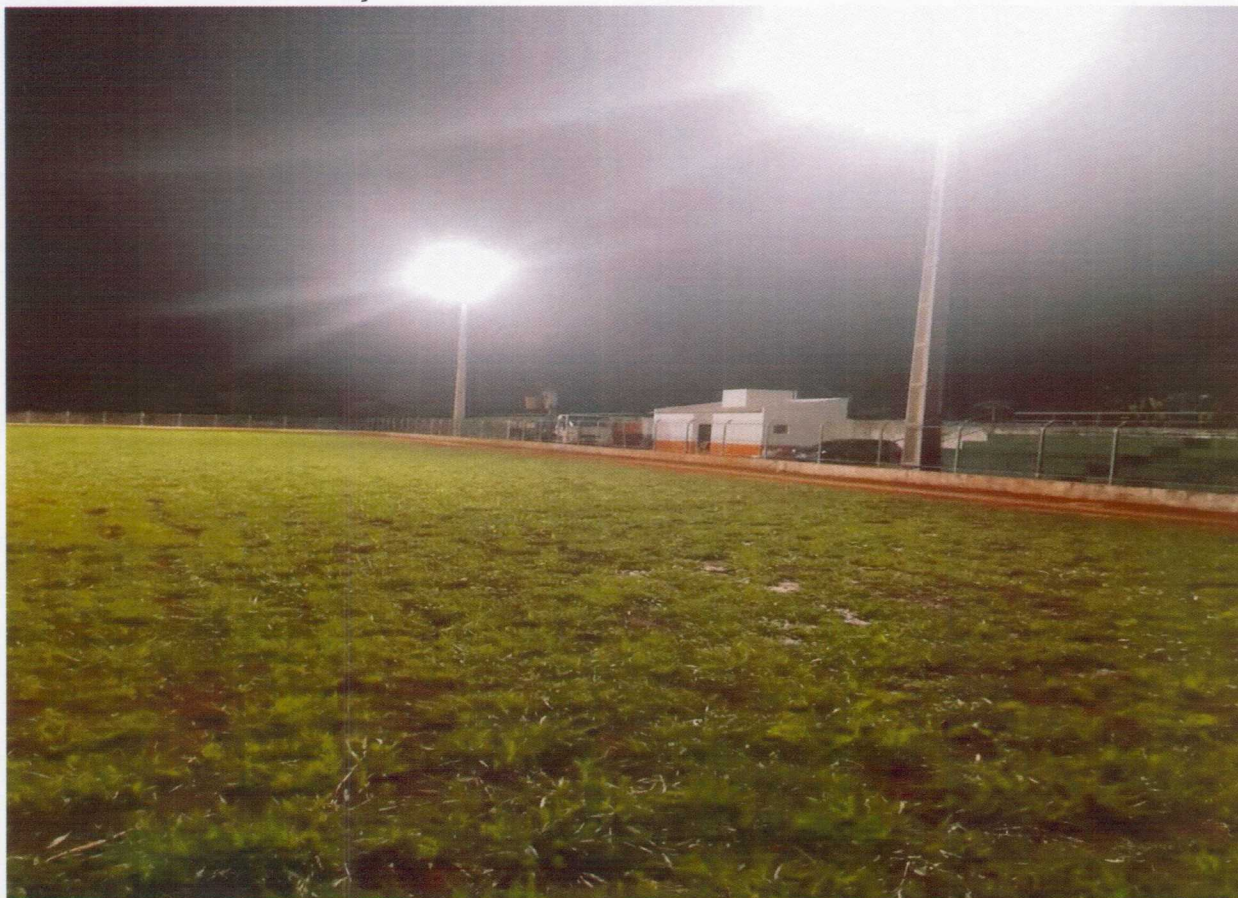
Foto 01 – SISTEMA DE ILUMINAÇÃO
