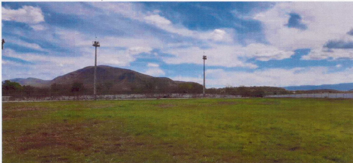
Foto 01 – SISTEMA DE ILUMINAÇÃO
