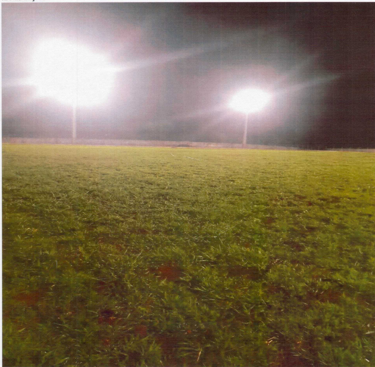
Foto 02 – SISTEMA DE ILUMINAÇÃO
