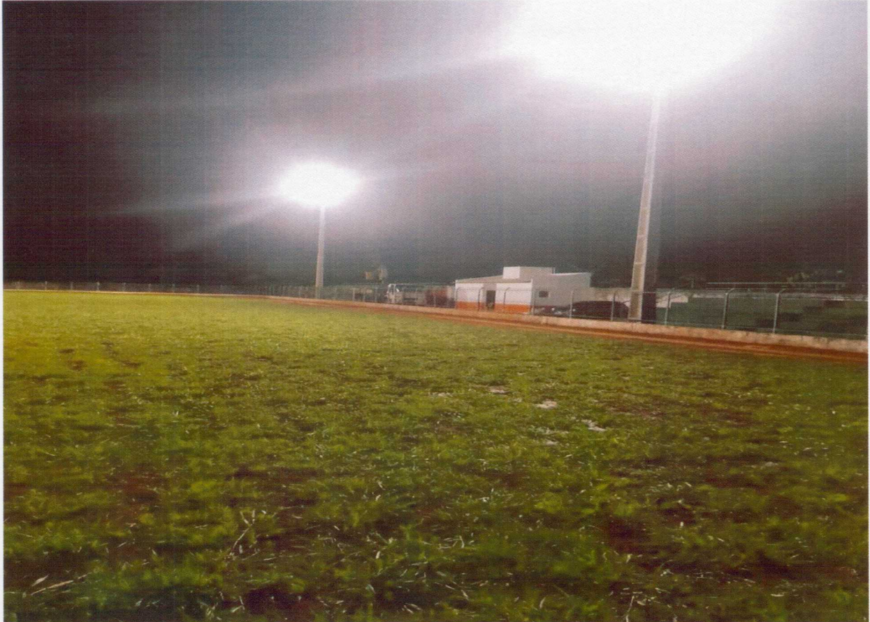
Foto 01 – SISTEMA DE ILUMINAÇÃO
