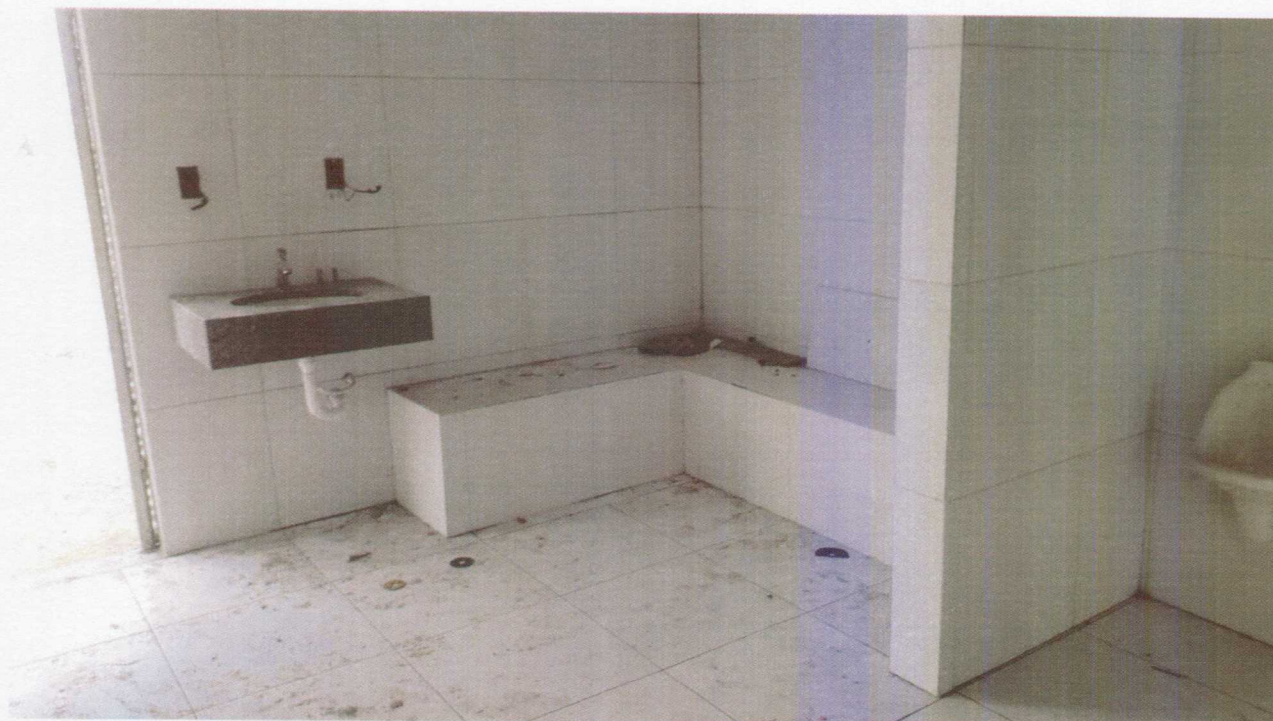
Foto 02 – Vista interna dos vestiário – Instalações elétricas e bancadas.
