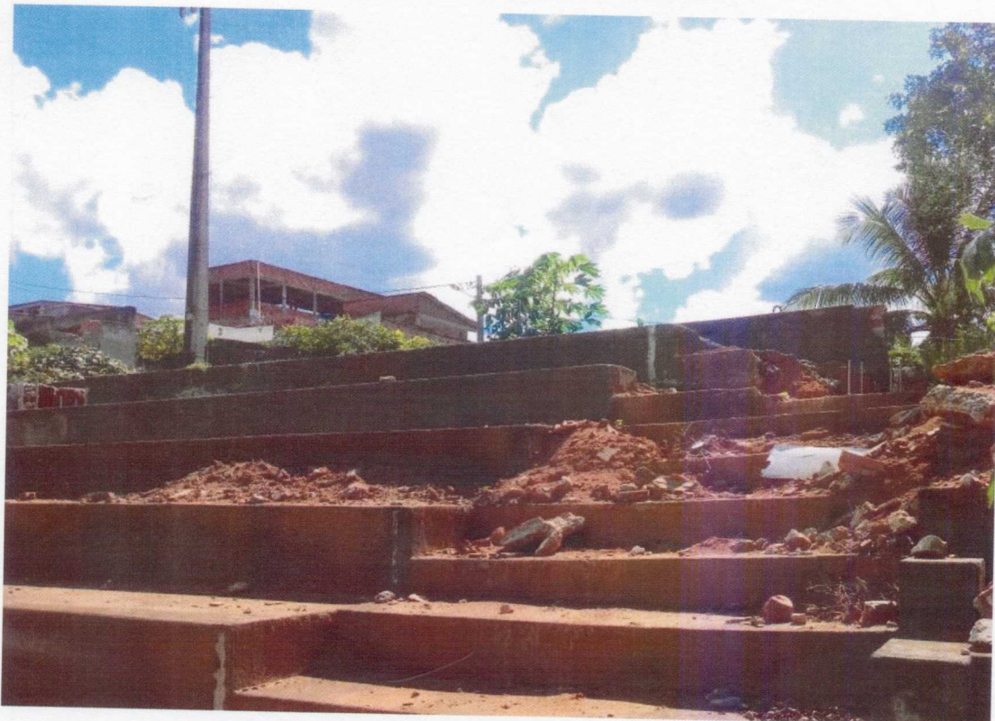
FOTO 02 – Resíduos da escavação da fundação, não retirados
