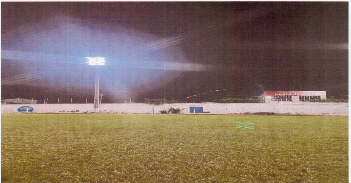
Foto 06 – poste com refletores.
